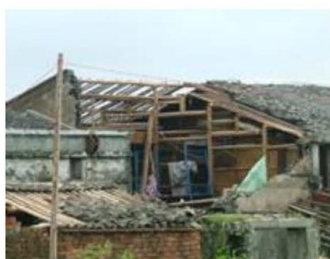
吹落屋面瓦片
