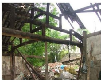
破坏屋盖构件节点连接
